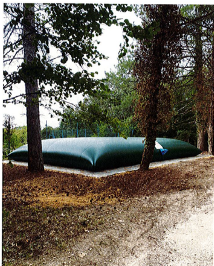
Citerne souple pour protection incendie installée à Busseau.
